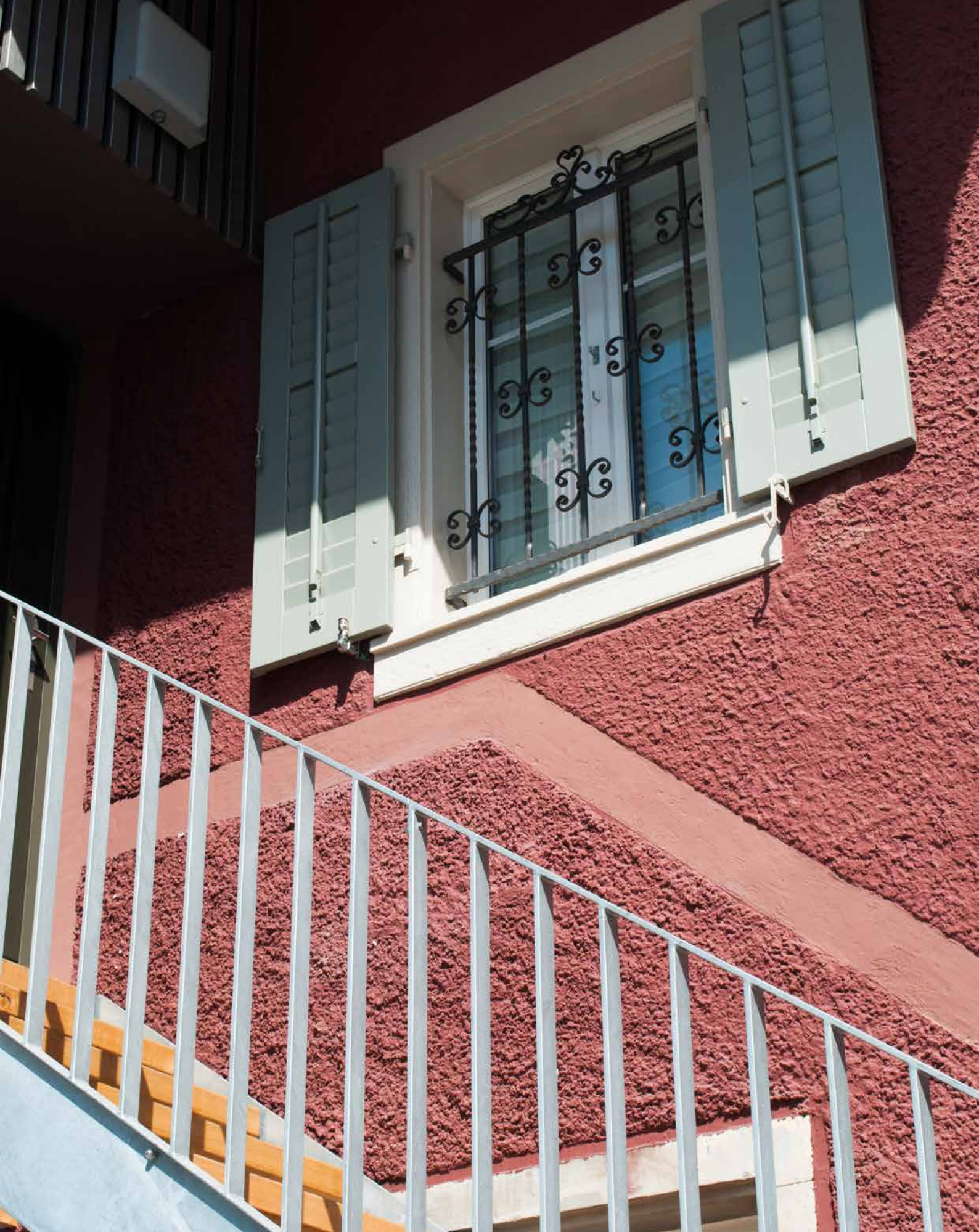
Rüti ZH: détail d'une maison conservée suite à l'arrêt du Tribunal fédéral de 2009. Ce bâtiment confère aujourd'hui une identité spécifique au nouvel ensemble construit alentour. Photo: Annemarie Straumann, EspaceSuisse
